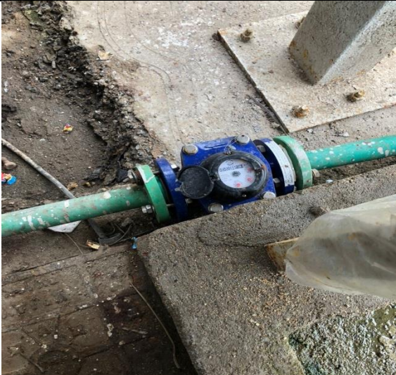
RO I/L flow meter
